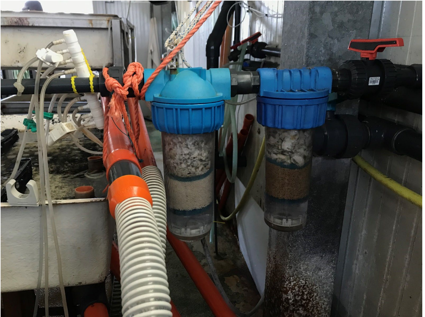
Figura 12. Sistema di filtri installati presso Naturedulis.
