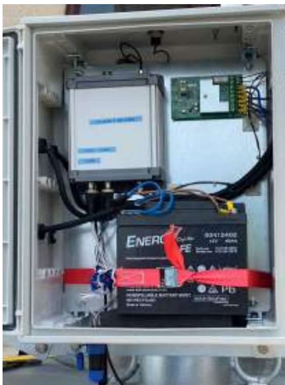
Figura 23- Sistema elettrico e datalogger contenuti all'interno della scatola impermeabile
